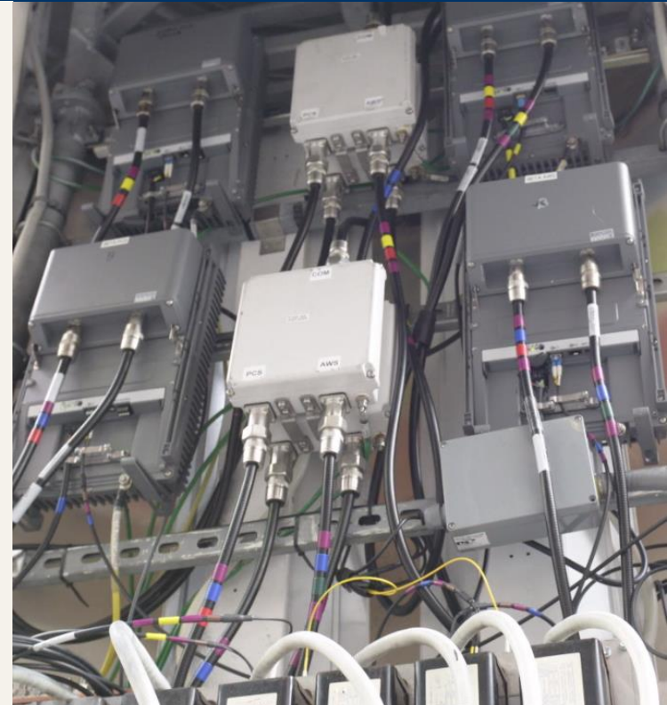
Installation de small cell dans une colonne
